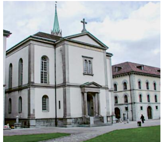
Die Schutzengelkapelle vor der Renovation 2018: Verfärbung der Putzoberflächen durch Algenbewuchs oder witterungsbedingten Farbbau, Abplatzungen und Ausbrüche bei den Natursteinpartien und offene oder zu harte Fugen. Neben den baulichen Schäden galt es auch architektonische Mängel wie die zu helle Fenster-Sprossierung, fehlende Putzstrukturen und eine undifferenzierte Farbgebung zu korrigieren.
