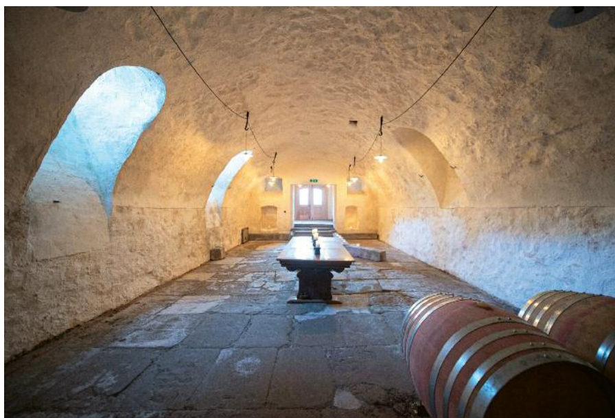
Der grosse Gewölbekeller mit dem wunderbaren alten Sandsteinboden. Im Osten die ehemalige Aussenwand mit Nischen, dahinter der neue axiale Zugang.
