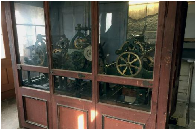
Uhrkasten mit dem mechanischen Turmuhrwerk von 1896 vor der Sanierung. Der präzise und aufwändig gezimmerte Uhrenkasten zeigt den Wert, welchen man damals dem Uhrwerk beigemessen hatte.
