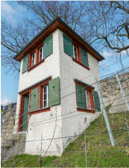
Vorzustand mit Putzschäden.
