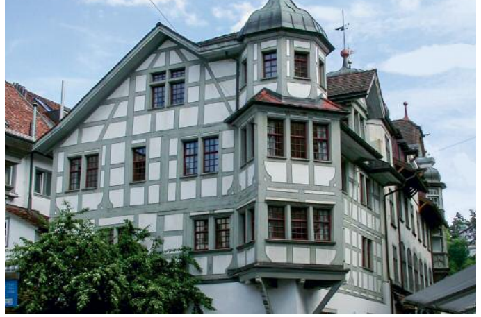
Aufnahme vor der Renovation 2019. Obwohl die letzte Fassadenrenovation fast 40 Jahre zurückliegt, sind das Riegelwerk und die verputzten Füllungen in einem guten Zustand erhalten, so dass sich die Unterhaltsarbeiten auf die wenigen Schadstellen im Riegelwerk und Verputz sowie auf einen neuen Farbauftrag auf dem Holz- und Mauerwerk beschränken konnten.
