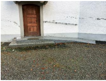
Schadhafter Fassadenputz neben dem Seiten- eingang Süd.
