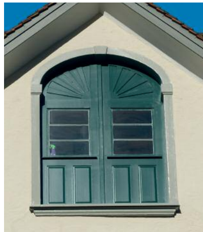
Auch wenn heute nicht mehr mit Holz geheizt wird, so sind Bauteile wie diese Aufzugsöffnung für die Erhaltung eines Gebäudes von Bedeutung. Sie prägen nicht nur das Fassadenbild, sondern hatten früher auch eine wichtige Funktion inne und bilden somit einen Teil der Nutzungsgeschichte.
