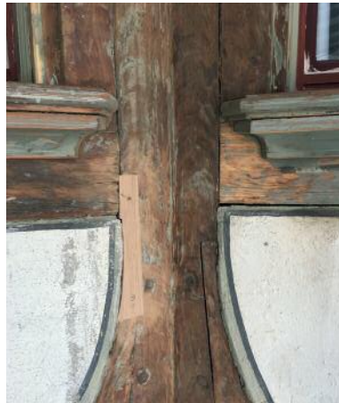
Musterstelle der durchgeführten Massnahmen. Schadhafte Holzpartien mit Echtholz-Vierungen ersetzt, rissiger und schuppiger Farbanstrich durch schleifen entfernt, grobe Risse durch schleifen entfernt, grobe Risse mit Ölkitt geschlossen.
